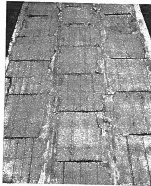
Fig. 18. Træksiden, efter at Bruddet i Tryksiden er sket. Nogle Blokke er revnede paa langs, andre paa tværs i Forlængelse af Naborækkens Tværfuger. Revnerne er fine paa Grund af den stærke Armering.
